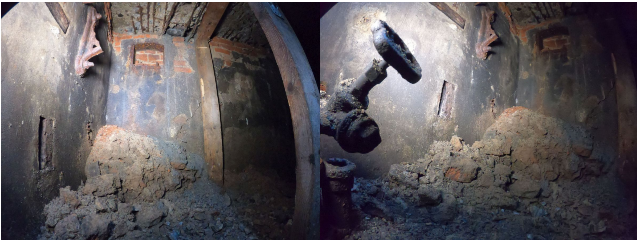
Plac Wolności - komora studni ukryta pod ziemią, ZWiK
