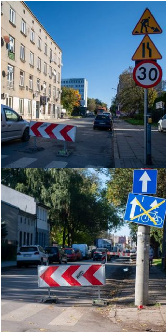
Remont trzech ulic przy Bałuckim Rynku rozpoczęty. Nowe jezdnie, chodniki, przystanki, ławki i drzewa
