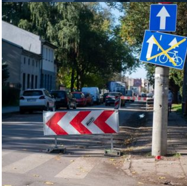
Remont trzech ulic przy Bałuckim Rynku rozpoczęty. Nowe jezdnie, chodniki, przystanki, ławki i drzewa
