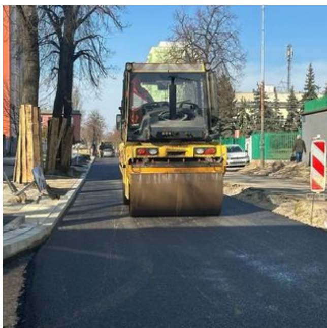
Remont Nowej w Łodzi. Pierwsza warstwa asfaltu i chodnik już widoczne [ZDJĘCIA]
